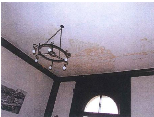
Рисунок 2.2.3 Надмірне зволоження (замочування) перекриття, вид знизу
