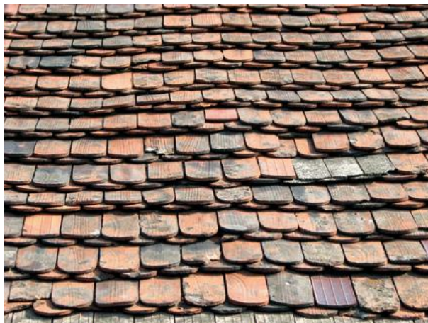
Рисунок 2.2.8 Деформація конструкції покриття даху та пошкодження окремих елементів покриття
