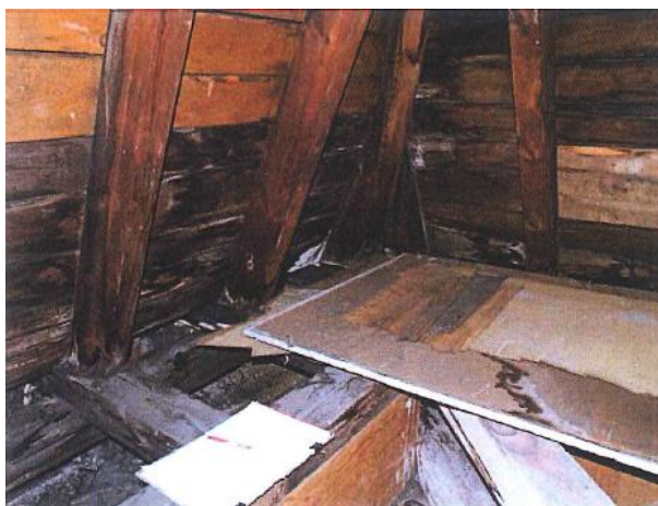
Рисунок 2.2.4 Надмірне зволоження (замочування) перекриття, вид зверху. Візуально помітне пошкодження дерев'яних елементів даху
